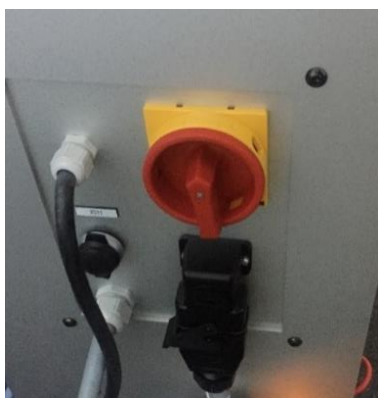
5. ábra: Elektromos főkapcsoló
